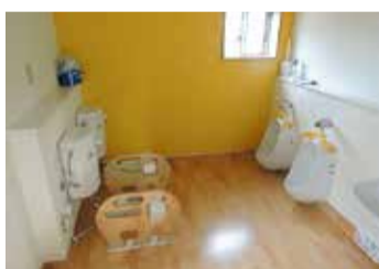
新築の保育園には、子ども用トイレを新たに設けた
